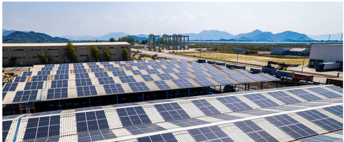
Prva sunčana Elektrana – Terminal rasutih tereta od 20 kW puštena u rad tijekom 2023.
