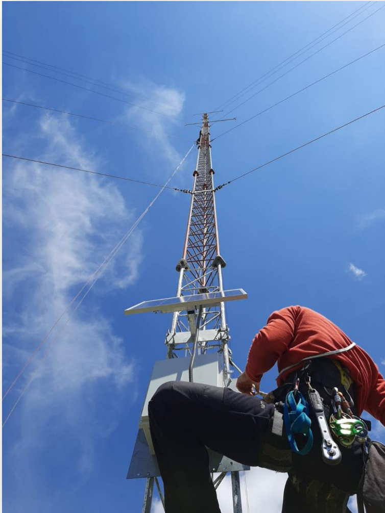
Mjerni stup za mjerenje vjetro potencijala
